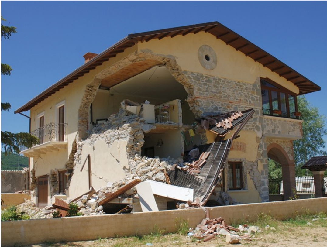
Fig. 1 - Una corretta analisi sismica a priori e l'applicazione di adeguati rinforzi strutturali avrebbero potuto "salvare" questa nuova villetta a Roio Piano in Comune di L'Aquila. Verrà completamente ricostruita su grossi pali gettati nell'argilla sottostante ad un costo elevato e totalmente finanziato!
