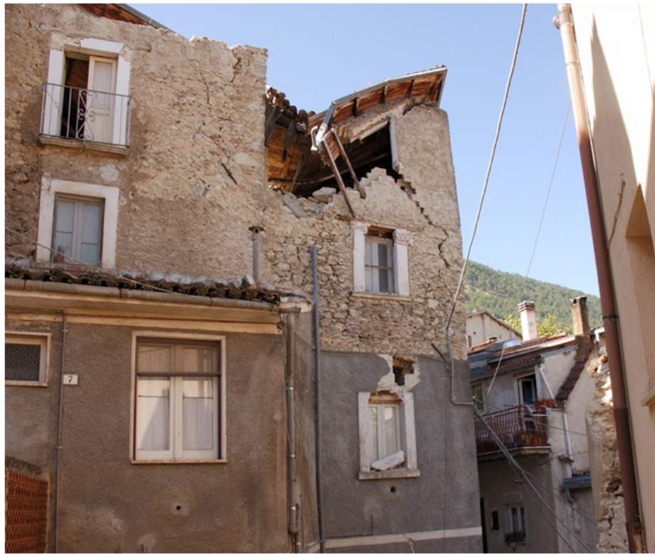
Fig. 3 – L'applicazione di tiranti in copertura avrebbe potuto evitare il crollo della medesima su questa casa nel centro storico di Bagno Grande in Comune di L'Aquila!
