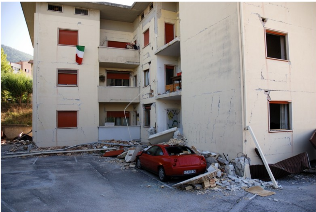
Fig. 2 - Una corretta analisi sismica a priori e l'applicazione di rinforzi strutturali soprattutto alla base che è crollata su se stessa, avrebbe potuto "salvare" questo condominio a L'Aquila!
