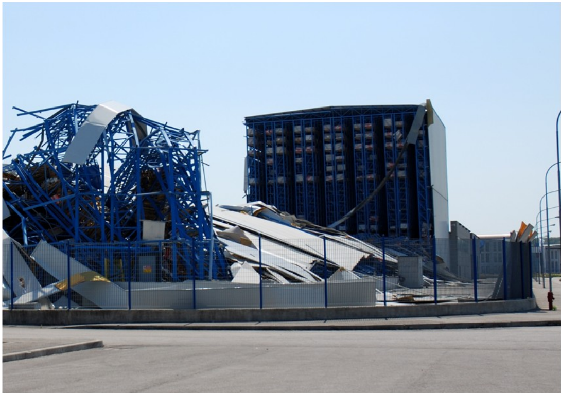
Fig. 6 – Una semplice analisi sismica avrebbe consigliato l'applicazione di controventi sufficienti ad evitare il crollo di questo alto magazzino per ceramiche multipiano in acciaio a Sant'Agostino, Ferrara.
