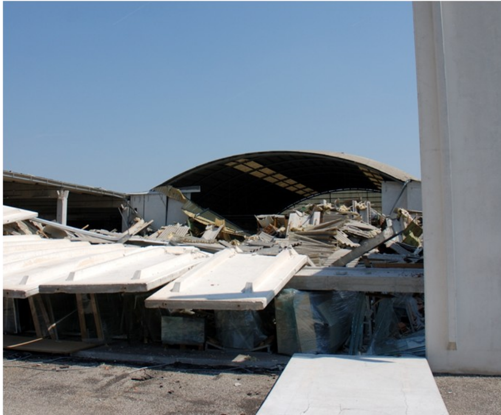
Fig. 7 – Una semplice analisi sismica avrebbe consigliato l'applicazione di controventi e di efficaci collegamenti strutturali, che sarebbero stati più che sufficienti ad evitare il crollo di questo capannone a Sant'Agostino, Ferrara.
