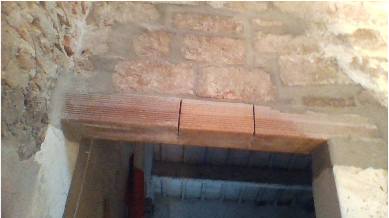
Le architravi, originariamente lignee, sono state sostituite con laterizio forato.
