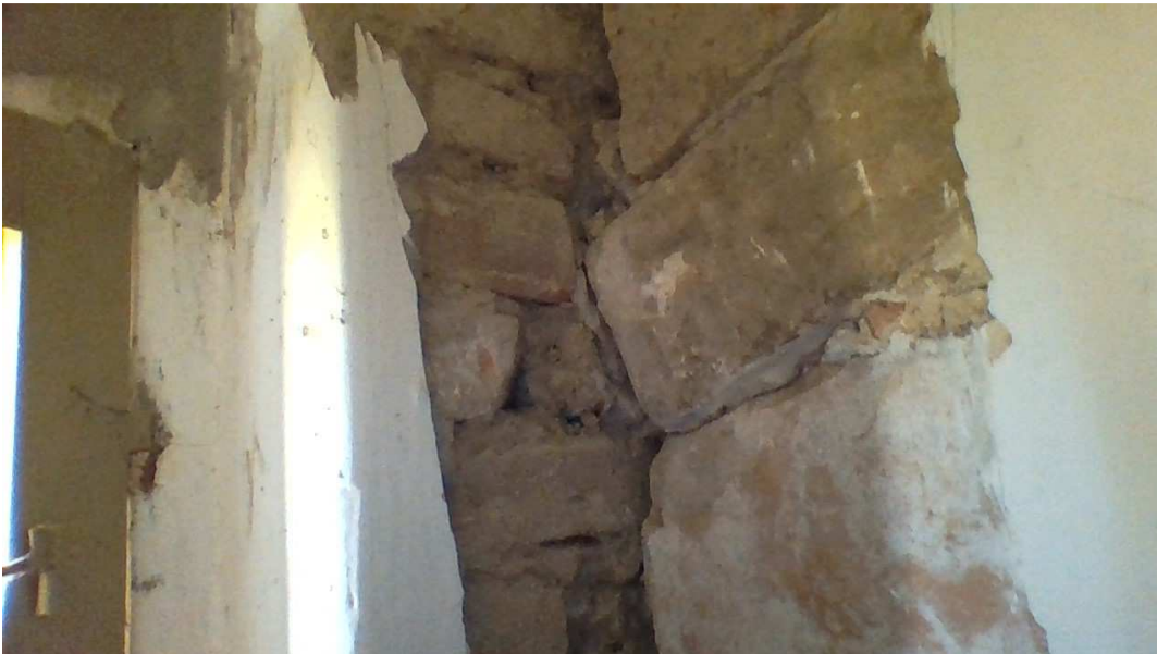
Ammorsamento inesistente, che ha richiesto un intervento di cucitura con barre metalliche da 12 mm inserite in serie da 3 per ogni muro.
