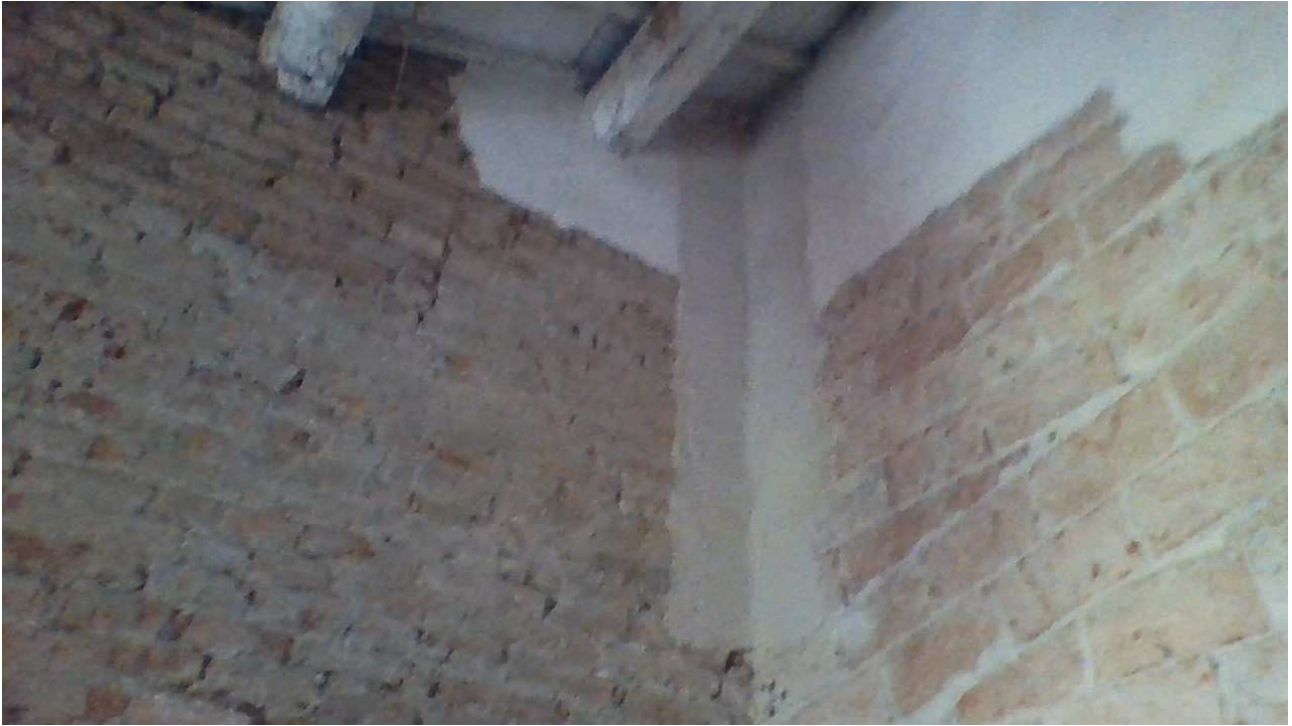
Lesione riparata con intonaco armato di larghezza 50 cm.
