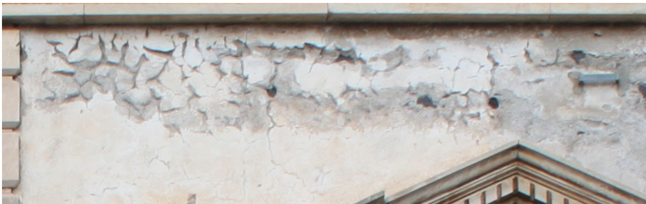
Particolare della porzione di intonaco sotto il cornicione sommitale di via V. Emanuele II, angolo sud -ovest
