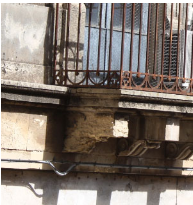
Particolare mensola balcone 4 di via Difesa
