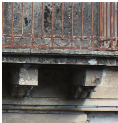
Particolare mensola, balcone 3 di via Difesa
