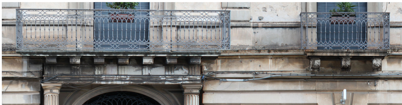
Particolare delle croste nere in corrispondenza del balcone centrale del fronte su via Vittorio Emanuele II.
