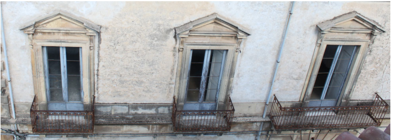
Particolare dei depositi superficiali sopra timpani e cornicioni in corrispondenza del fronte su via Difesa.
