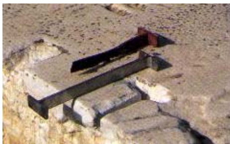
Εικόνα Β.2: Ένας παλιός, οξειδωμένος, μεταλλικός σύνδεσμος του Παρθενώνα δίπλα στον αντικαταστάτη του από τιτάνιο (25).
