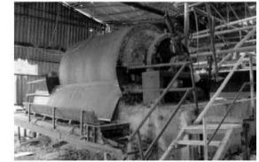
6. Filtro a depressione
