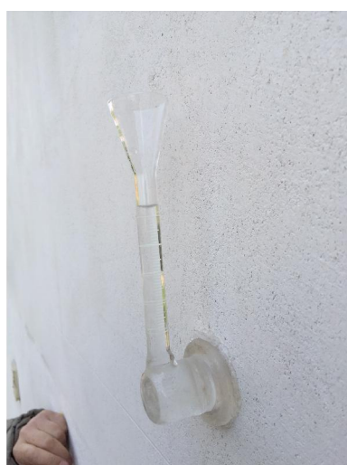
Misura col tubo di Karsten, sulla superficie trattata con idrorepellente linea Ector
