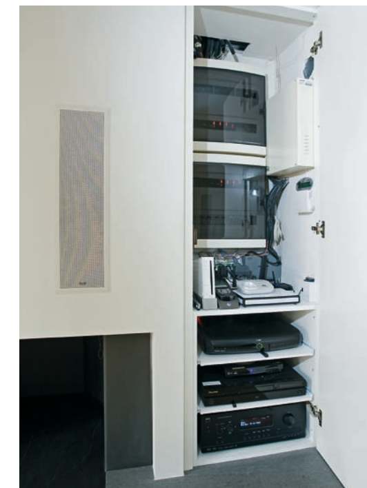
Nel salone, sulla destra, è stato ricavato un vano assolutamente invisibile che ospita tutti i componenti, compreso il quadro elettrico (con i moduli domotici).
