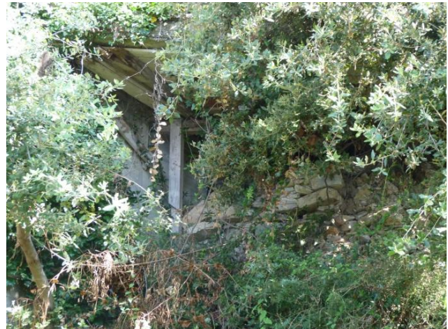
Condizione muri di contenimento 2 (sotto al Santuario)
