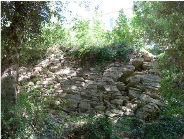
Condizione muri di contenimento 1 (sotto al Santuario)
