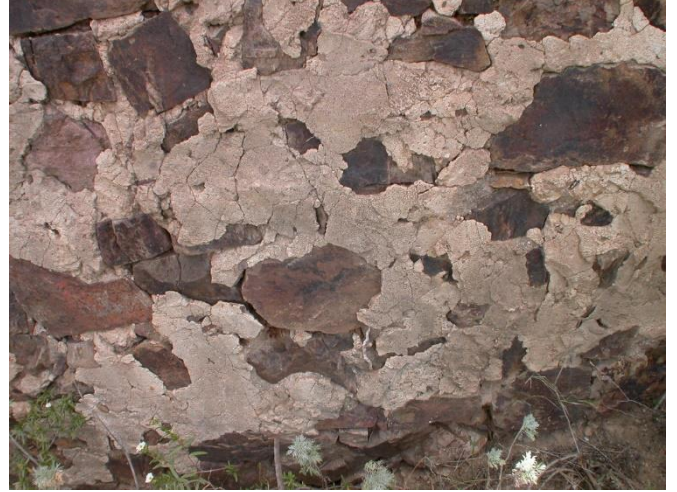
Intonaco della cinta muraria del Borgo
