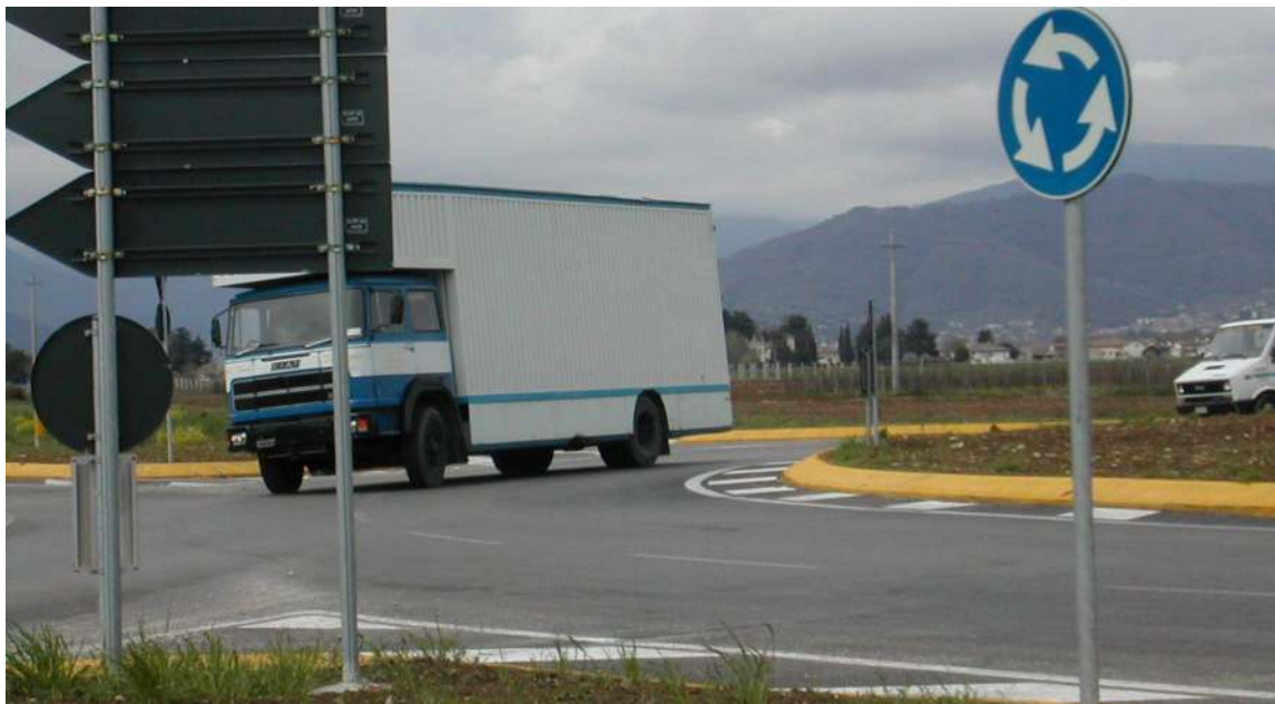
L'inclinazione eccessiva e pericolosa del camion è dovuta alla pendenza errata della corsia di marcia nell'anello
