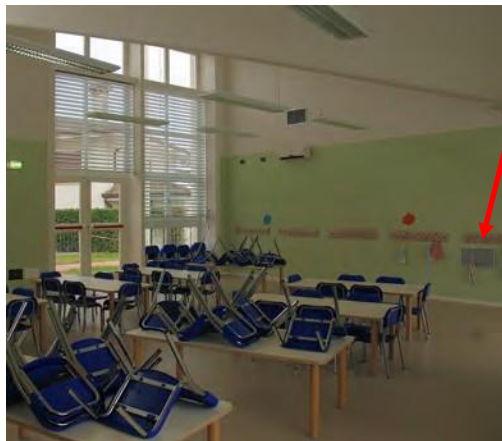
Fig. 99 - Vano di uscita dell'aria viziata nel piano interrato. Scuola Materna di Contea Progetto impianti ing. Giorgio Bedin
