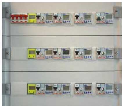
Fig. 102 - Quadro di contatori e timer per il rilievo dei consumi elettrici dei ventilatori e la programmazione di funzionamento dei medesimi Scuola Materna di Contea. Progetto impianti ing. Giorgio
