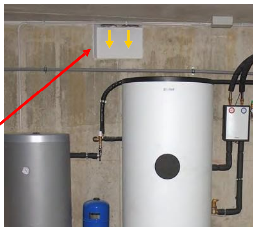
Fig. 98 - Griglia di uscita dell'aria viziata verso il piano interrato. Scuola Materna di Contea Progetto impianti ing. Giorgio Bedin
