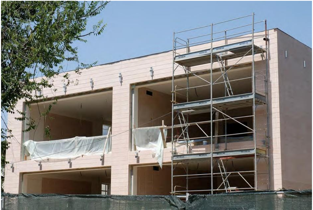
Fig. 54 - In questa foto sono visibili le strutture portanti composte da setti e travi di bordo in calcestruzzo (colore bianco), l'intercapedine contenente la coibentazione (minimo 10 cm), la parete esterna di protezione della coibentazione in blocchi di calcestruzzo da cm 12 di spessore (colore rosa) e la parete interna di tamponamento in blocchi di calcestruzzo da cm 12 di spessore (colore rosa). I supporti in acciaio zincato di supporto dei montanti dei parapetti della copertura sono fissati direttamente alla sottostante struttura portante. Le tecniche descritte sono state applicate nella costruzione di quattro aule di una scuola media. Lo spessore finito delle murature è in questo caso di 52 cm.
