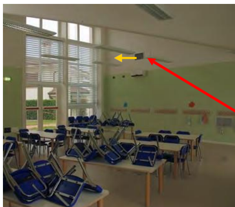
Fig. 96 - Ingresso dell'aria preriscaldata ai vani superiori e ventilatore di spinta dell'aria verso la serpentina a soffitto e l'ingresso ai vani superiori. Scuola Materna di Contea. Progetto impianti ing. Giorgio Bedin
