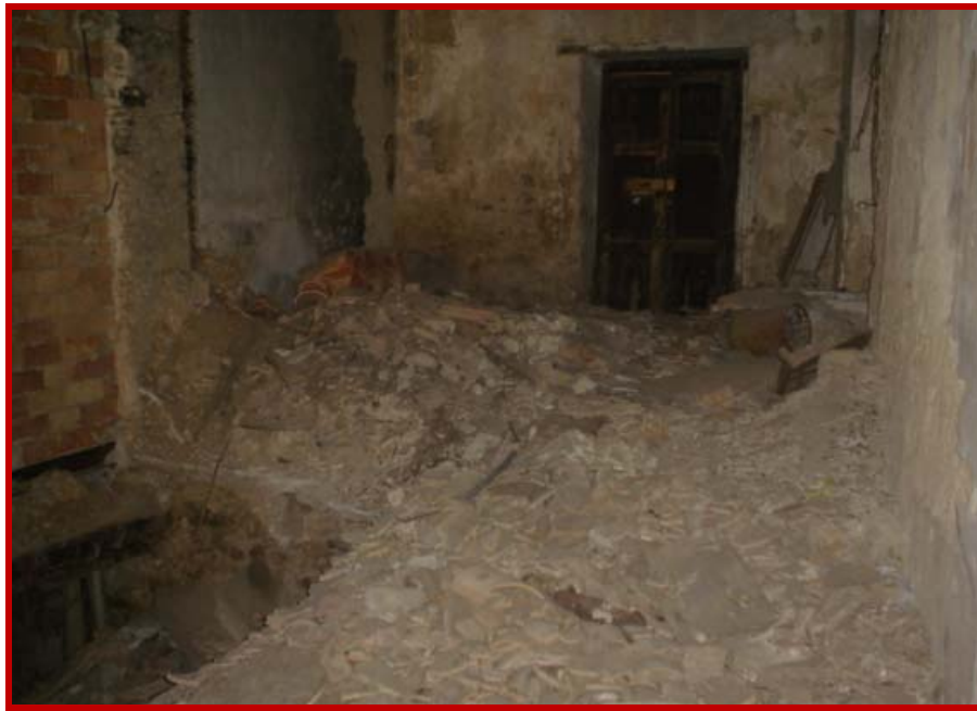
Crollo parziale di un solaio
