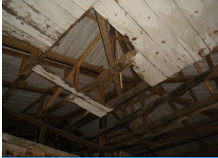
Crollo parziale di un controsoffitto ligneo
