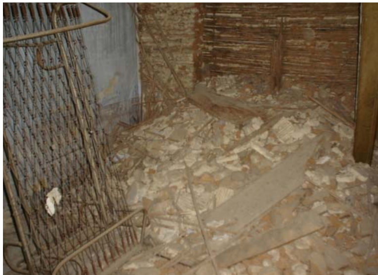
Crollo parziale di un solaio
