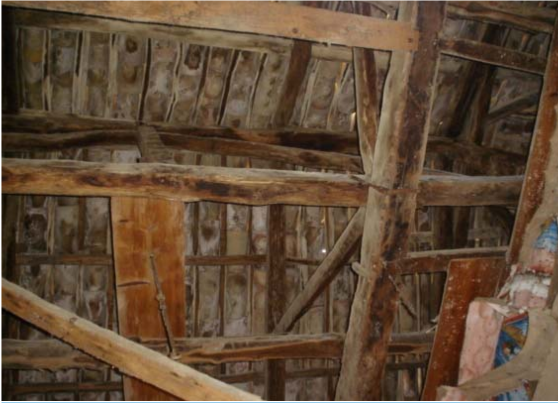
Crollo totale del controsoffitto ligneo
