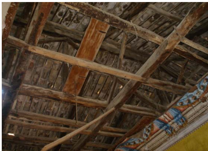
Crollo totale del controsoffitto ligneo
