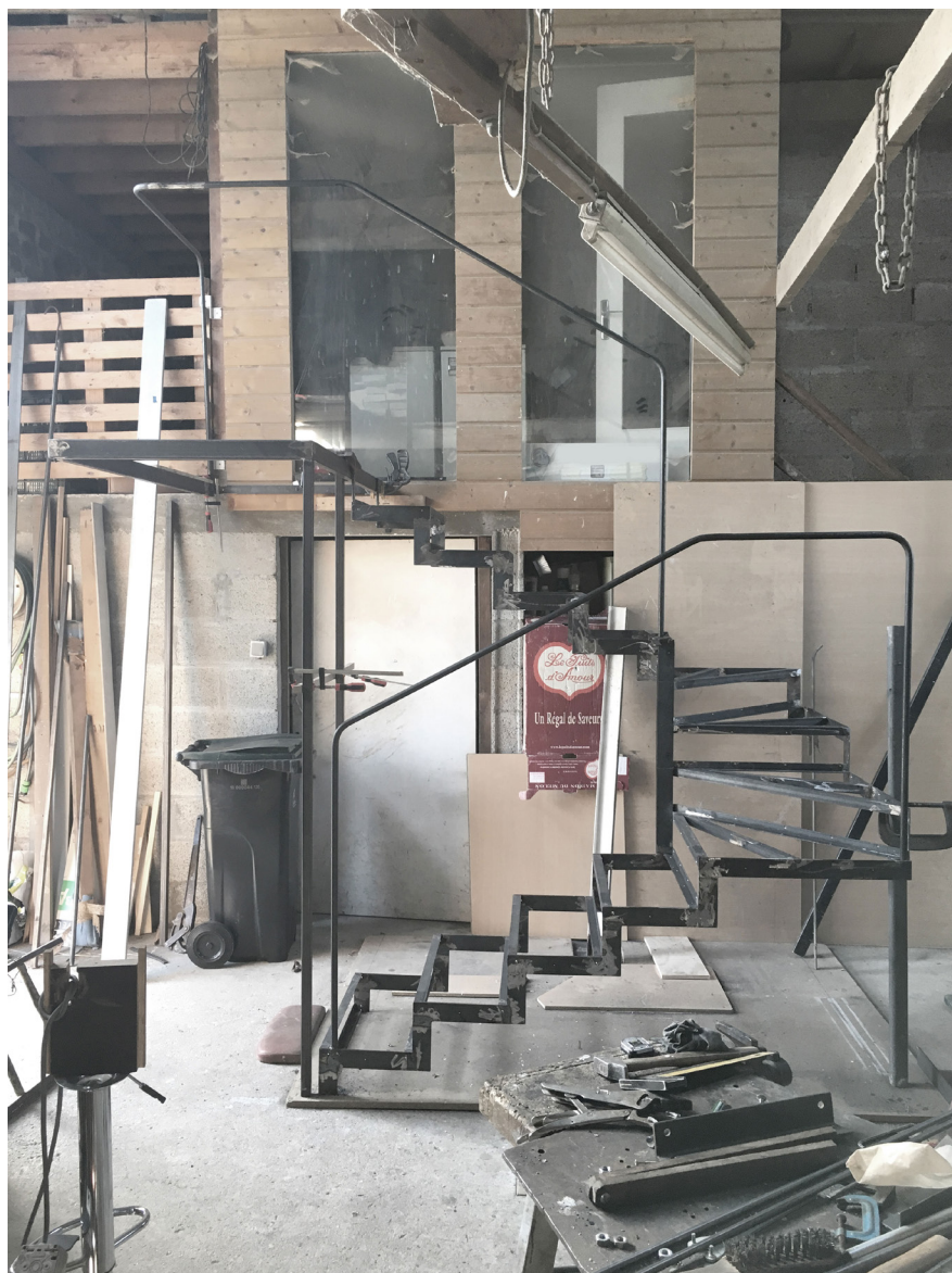
Assemblage de l'escalier principal en atelier, partie supérieure / Assembly of the main staircase in the workshop, upper part Photographie par Office Zola
