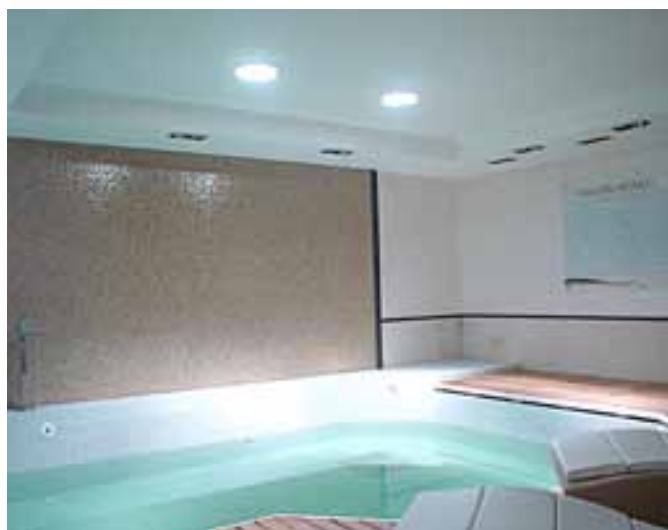
Bagno termale interrato con Lightway® 400HP - DOPO
