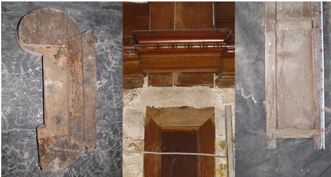
***Remate de pilastra, zona de inserción del mismo y deterioro de la trasera.
