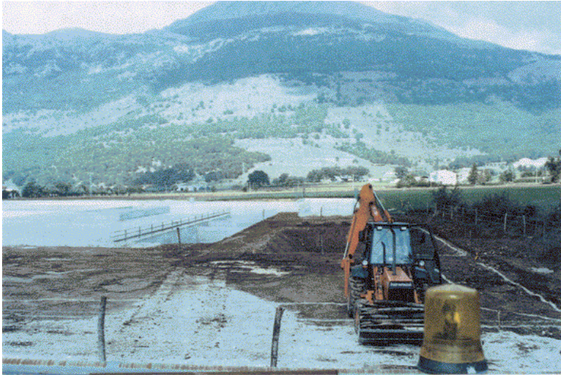
Primo piano della vasca in c.a. acqua di riciclo e fanghi e 1° vasca in terra acqua industriale
