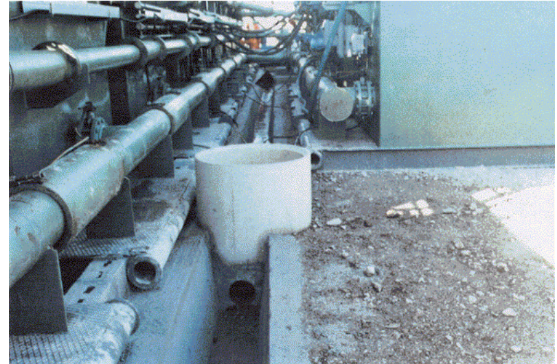
Primo piano pozzetto di solettore
