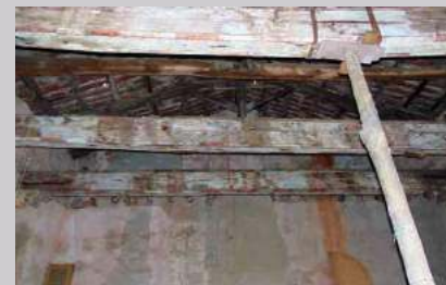
Tre travi in legno decorate e lesioni su parete est
