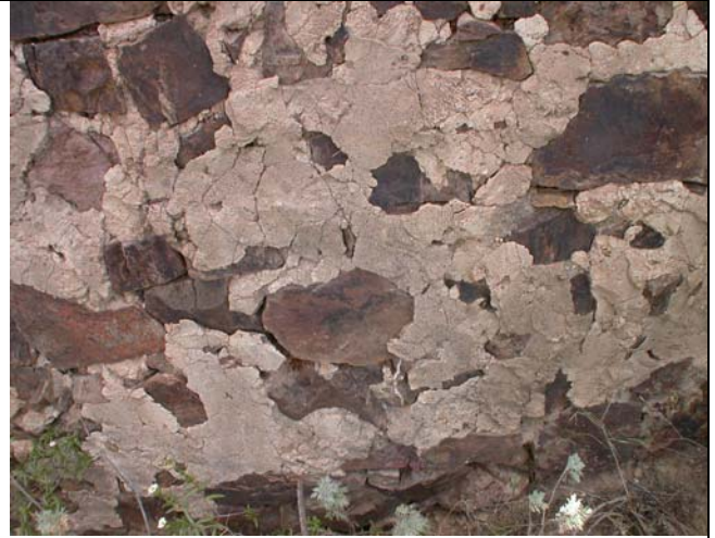
Intonaco della Cinta muraria del Borgo
