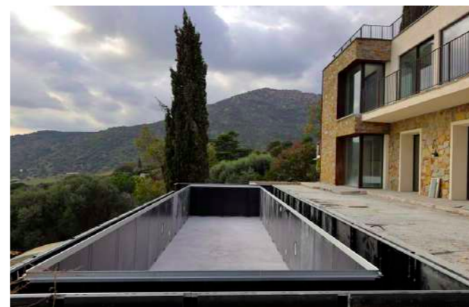
Struttura piscina Bluespring con lato a cascata "infinity"
