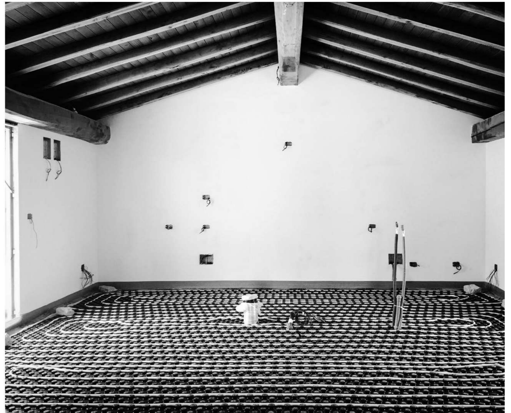
_impianto di riscaldamento e raffrescamento
